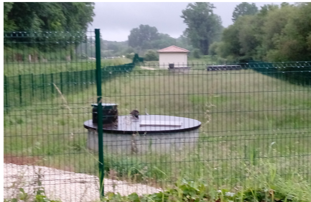
▲ Station de pompage de Fongrenon
